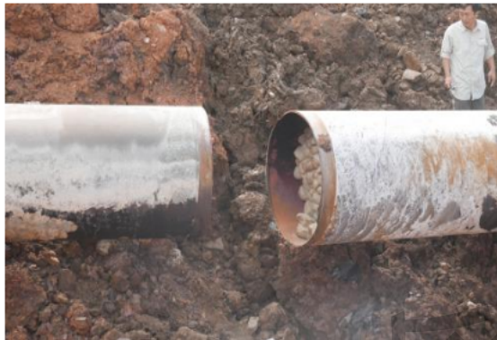
图2 中缅管道贵州段X80管道失效断裂
