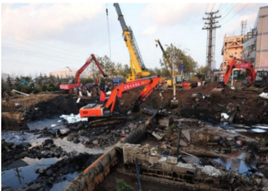
图1 青岛11.22 管道特大事故
