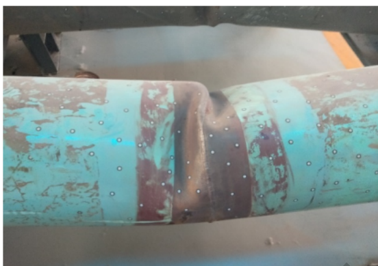
图3 海底管道屈曲变形
