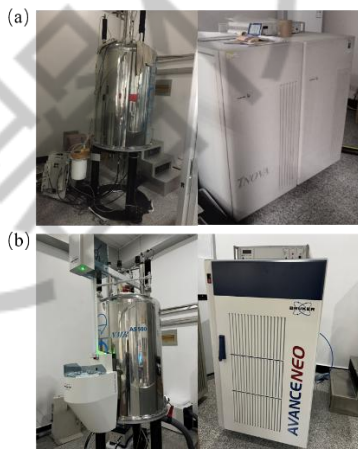
图 3 核磁共振谱仪磁体和机柜（a）升级改造前（b）升级改造后
